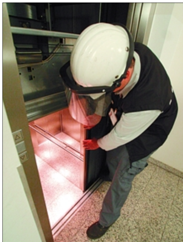
Mike Tafel, Servicetechniker bei DeTelmmobilien, wartet einen Fahrstuhl in einem Gebäude in Stuttgart. Foto: PPP-Kompakt/Kevin Schulz
